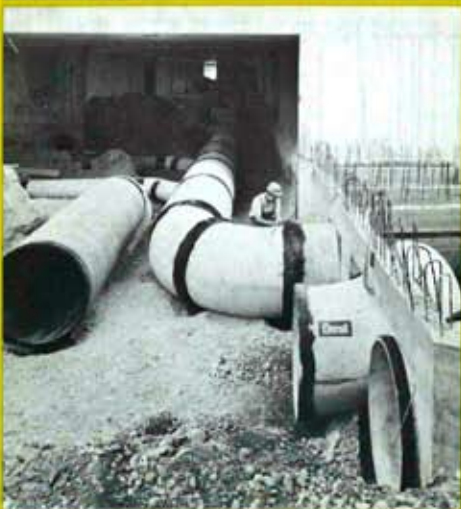
Links oben: Brunnenrohre DN 800 in einem Braunkohlenrevier.
